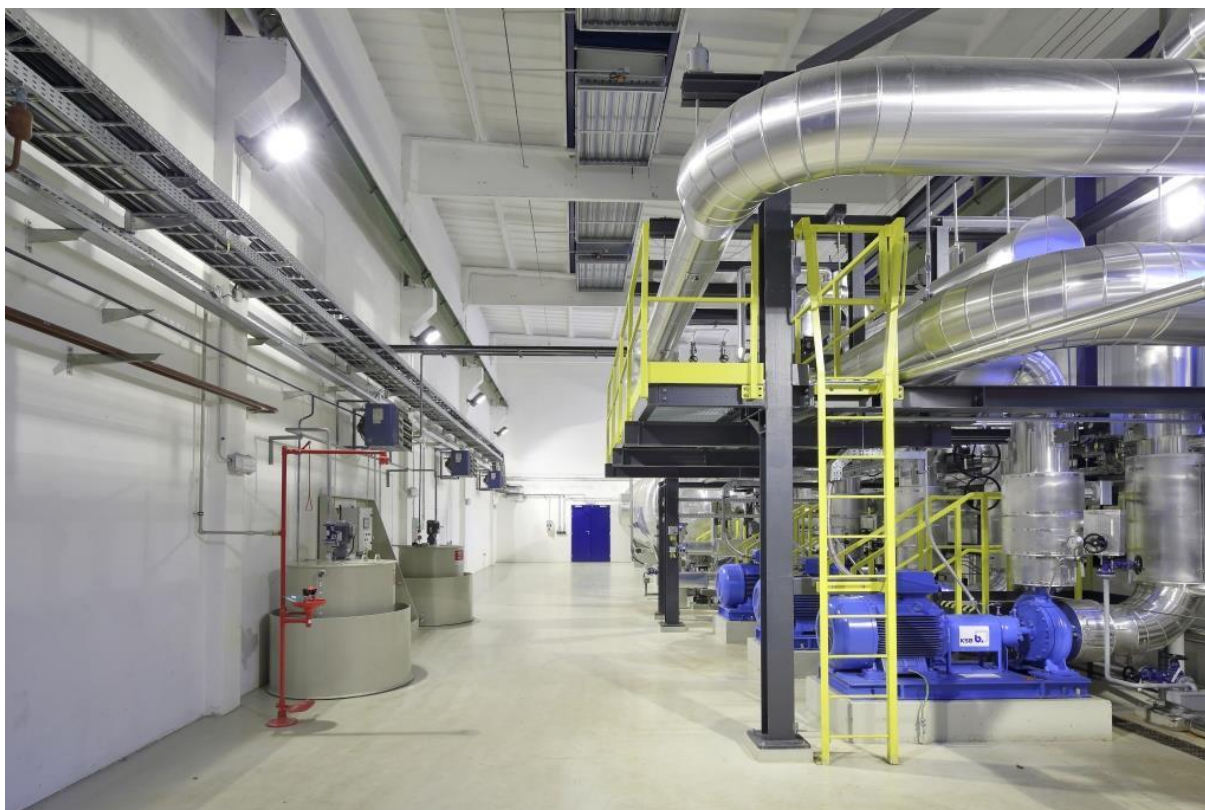
Zázemí čerpadel topné vody, nádrže s čerpadly pro dávkování chemie
