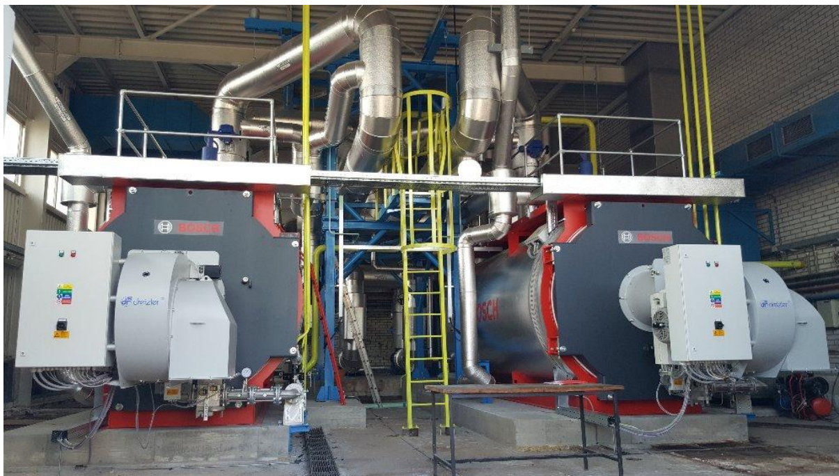
Teplárna KV - kompletně osazené kotlové jednotky s hořáky
