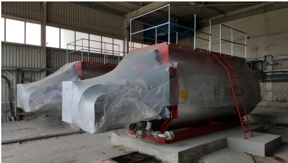
Teplárna KV - ustavené nové kotlové jednotky
