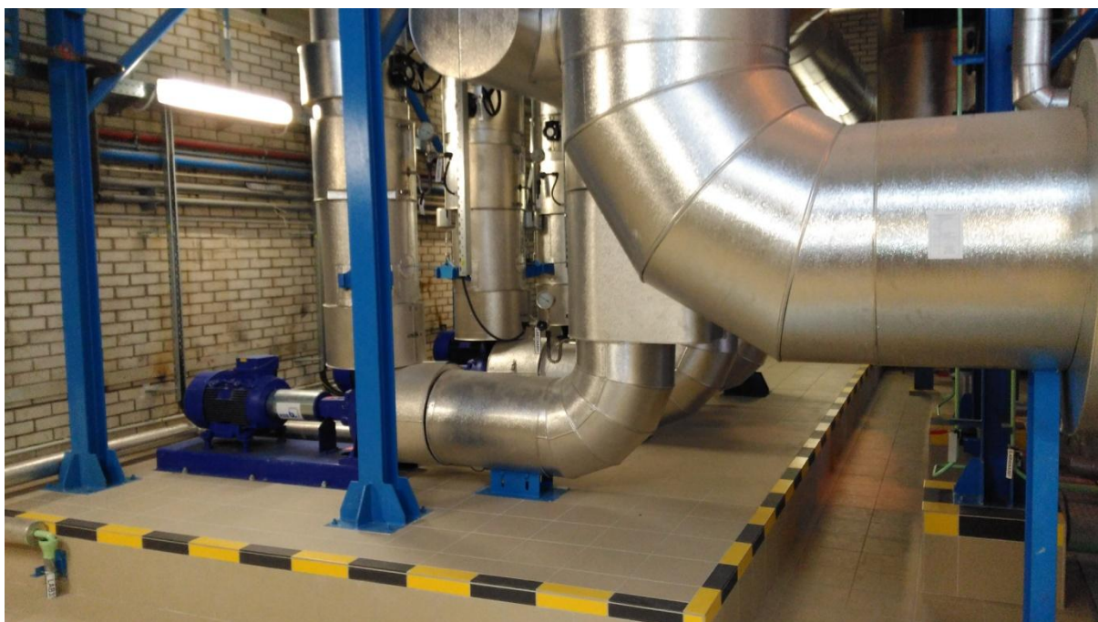
Teplárna KV - nainstalovaná čerpadla I. okruhu
