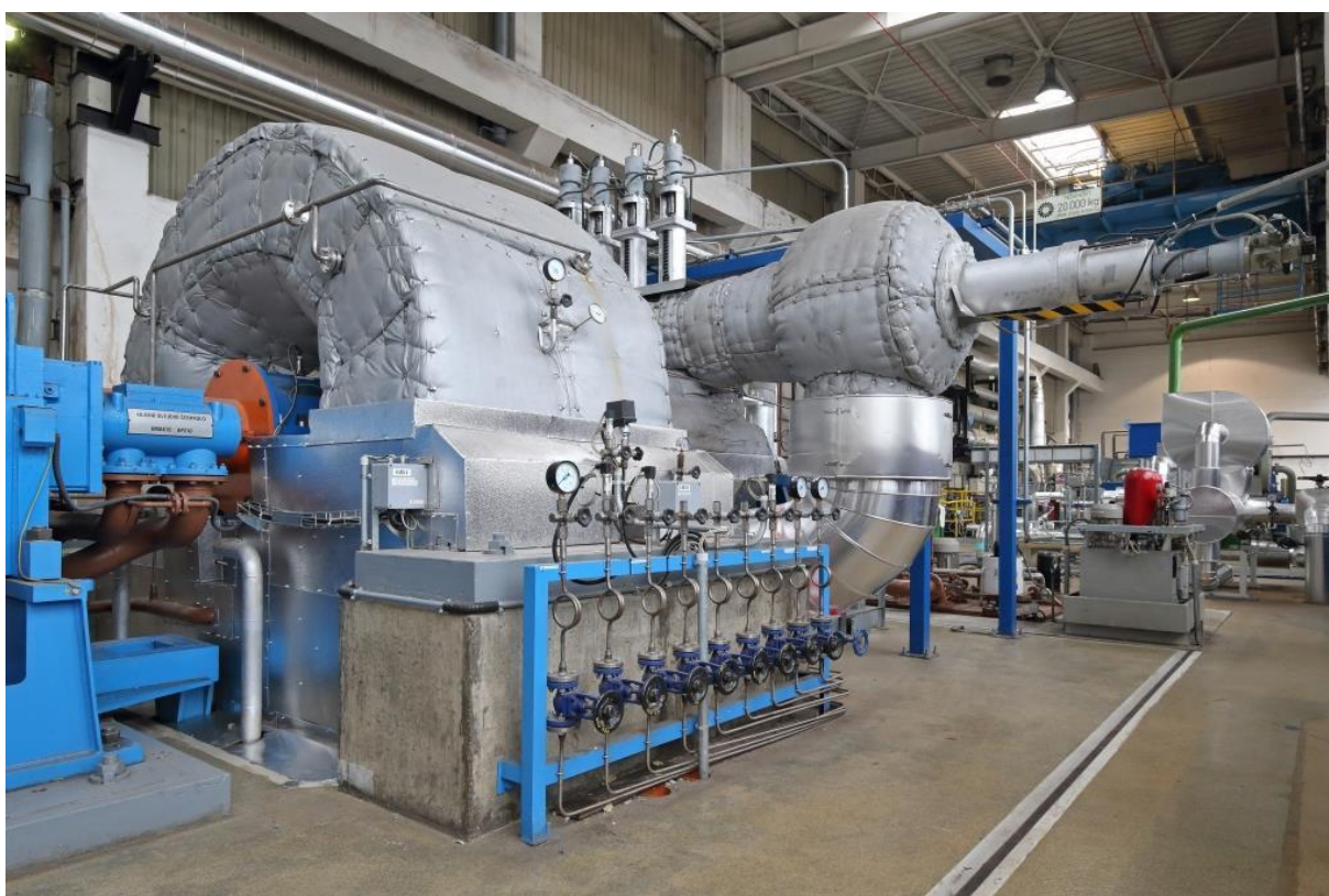
Zrekonstruovaná TG6 s nově zaizolovanou NT částí
