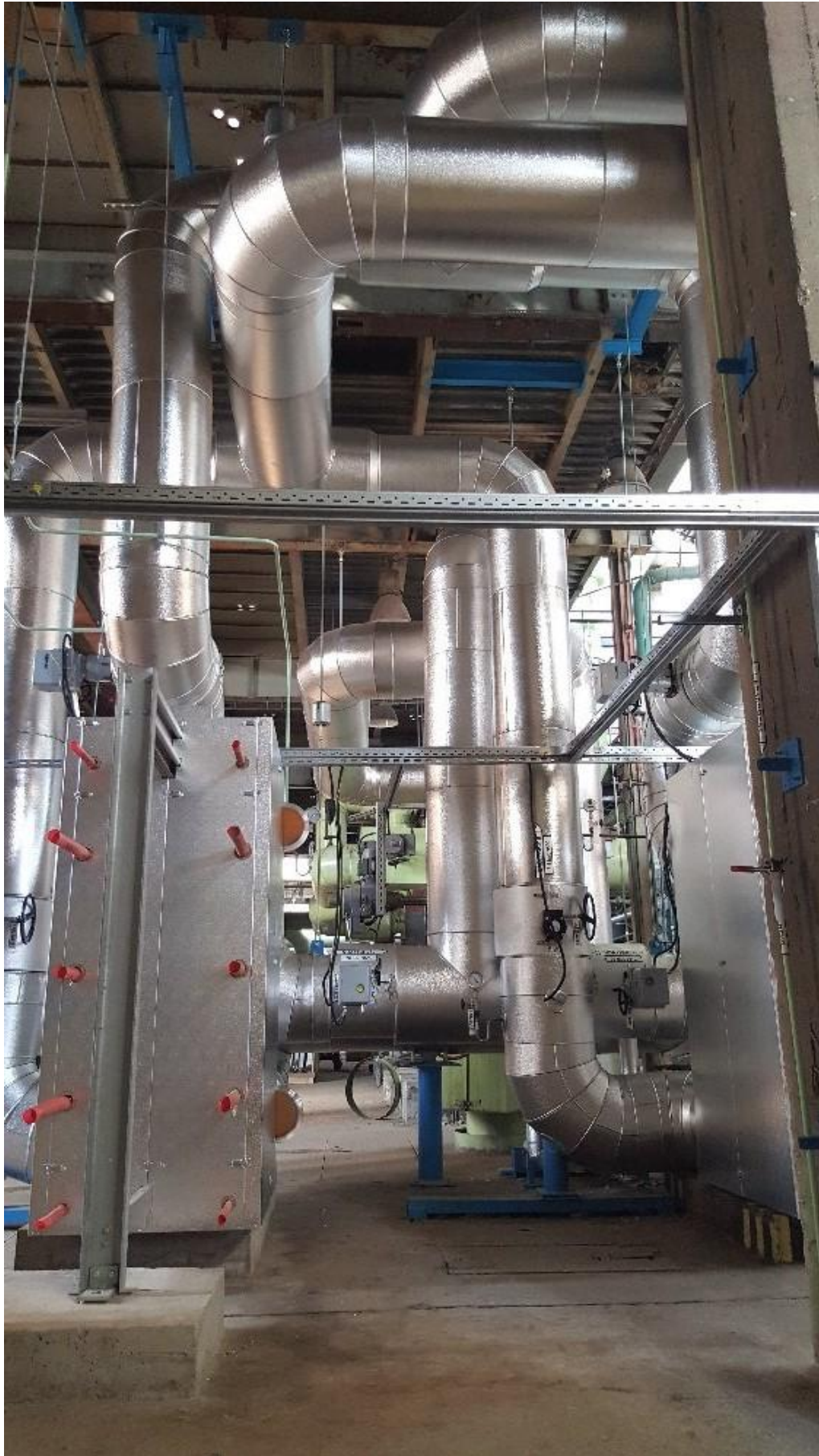
Teplárna KV - zaizolované výměníky I. a II. okruhu
